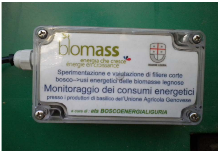
Registratore installato sulla caldaia
