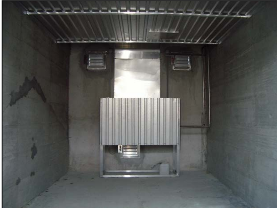
Figura 10: La cella di essiccazione situata vicino alla caldaia di Rossiglione
