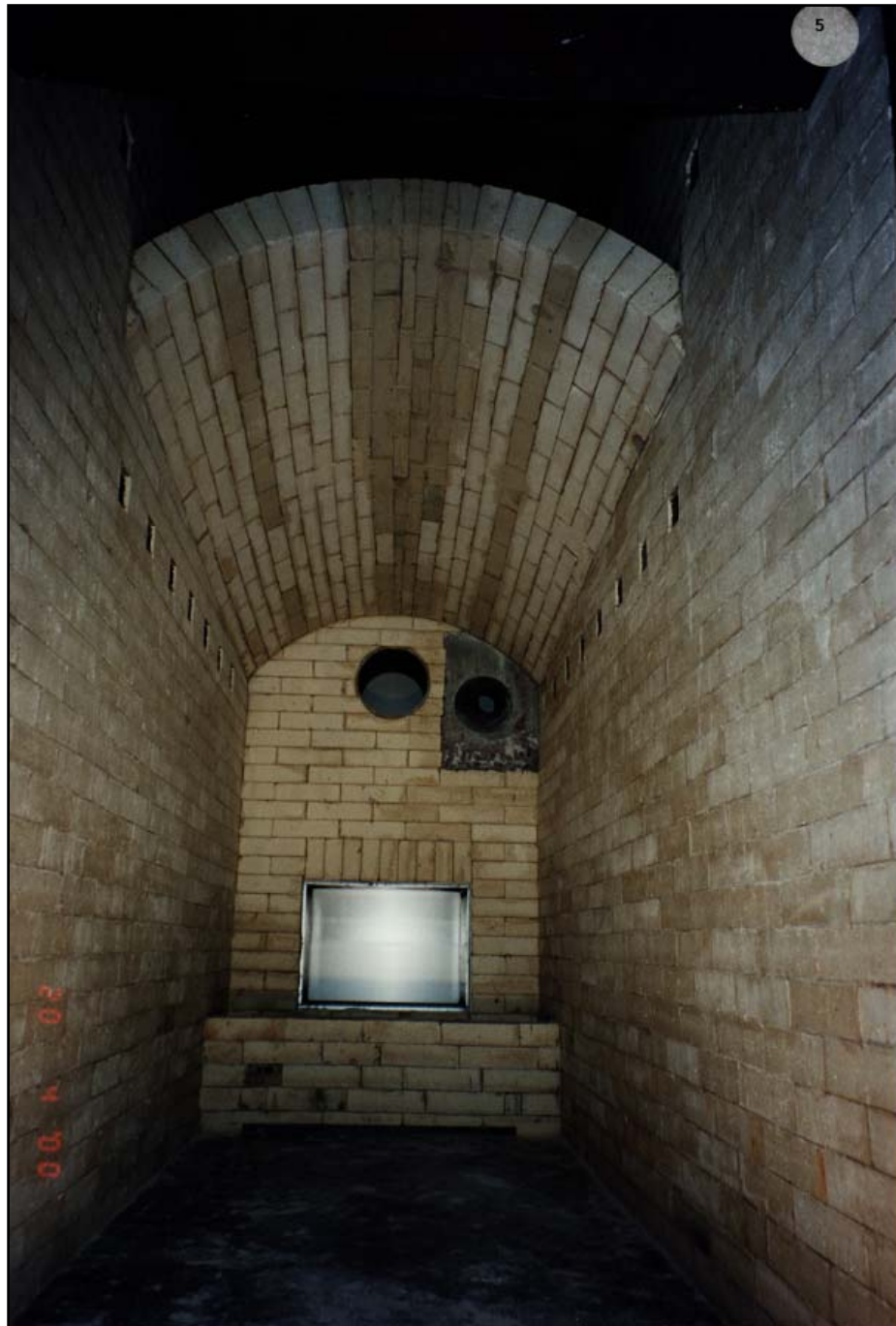
Figura 9: La camera di combustione
