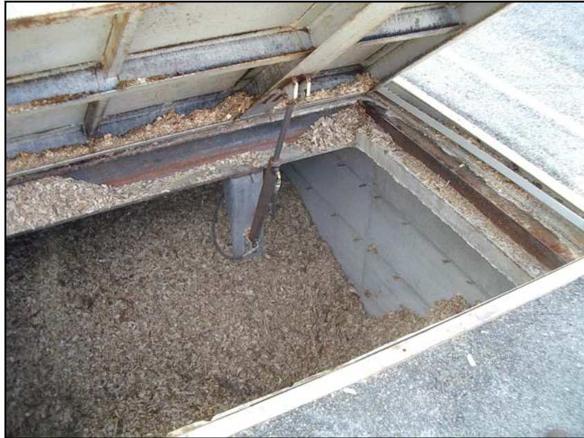
Figura 2: Il silo di stoccaggio
