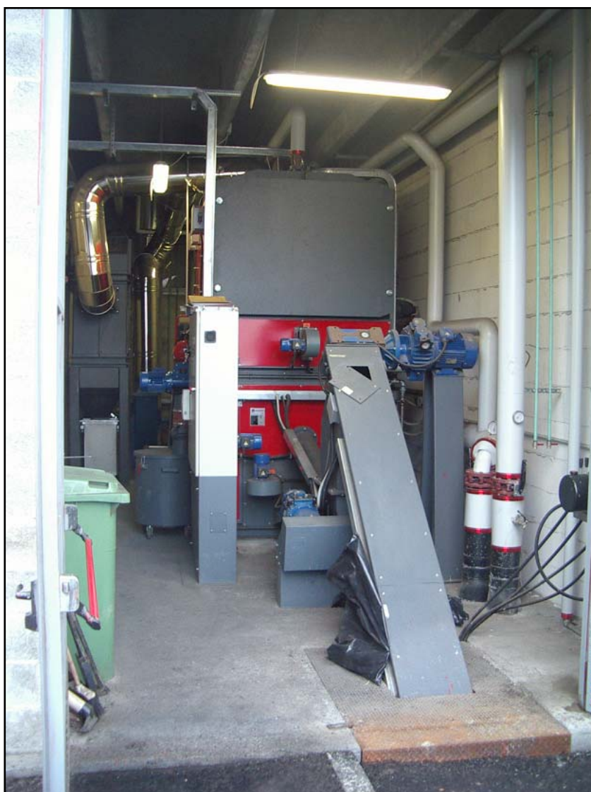
Figura 1: La caldaia di Campo Ligure
