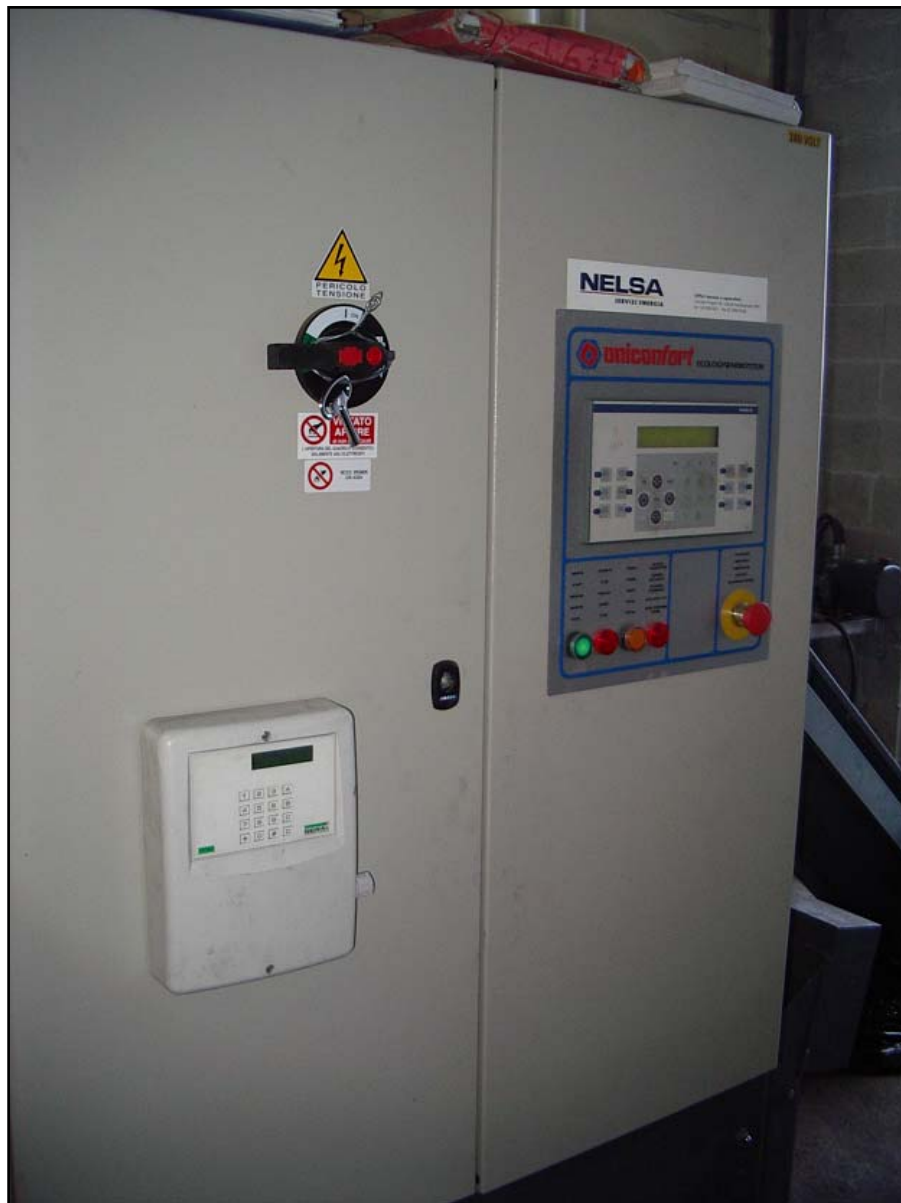
Figura 7: Il quadro elettronico
