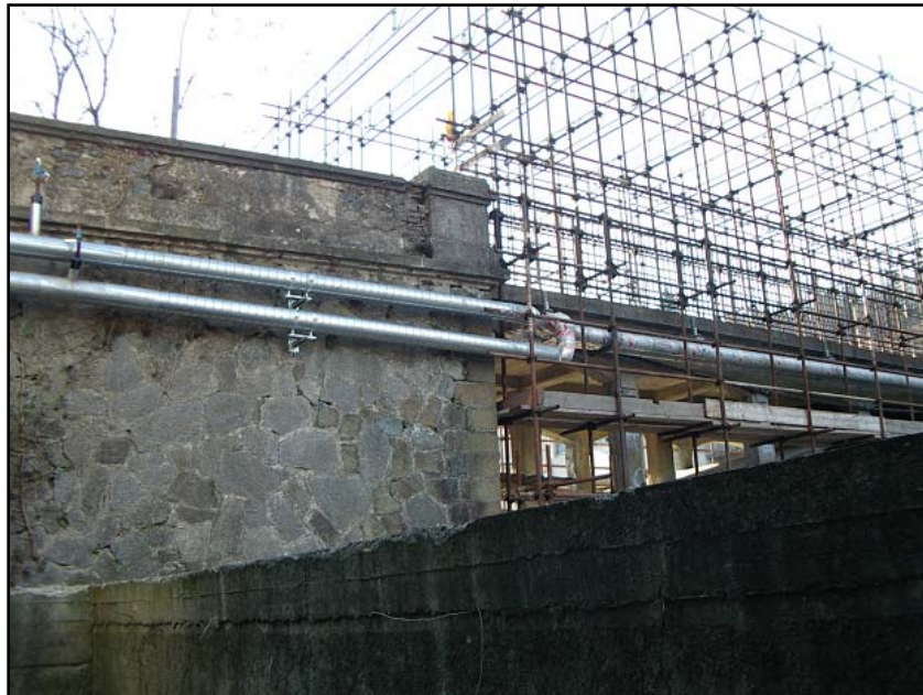
Figura 4: Particolare della rete di teleriscaldamento di Rossiglione
