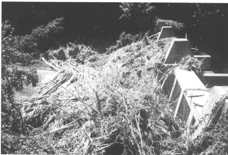
Campo Ligure: briglia selettiva sul torrente Ponzema dopo le piene torrentizie del giugno 1904
